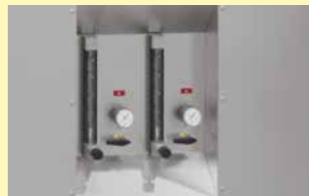
Système d'alimentation en gaz automatique
