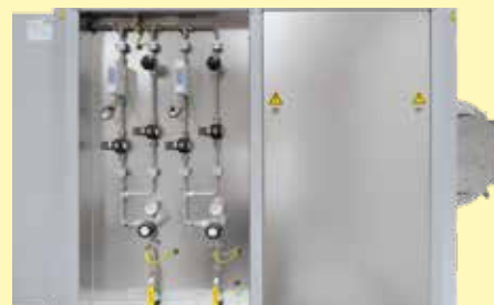
Système d'alimentation en gaz avec régulateur de débit massique
