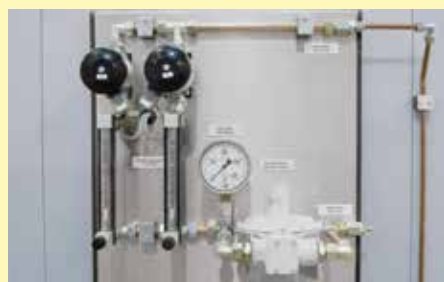
Système d'alimentation en gaz pour gaz protecteurs ou réactifs non combustibles
