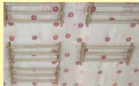
Recouvrement de l'isolation en fibres avec un tissu pour réduire l'empoussièrisme à l'intérieur du four
