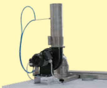
Apertura di presa d'aria e potente ventola per i gas di scarico aria montate sul forno
