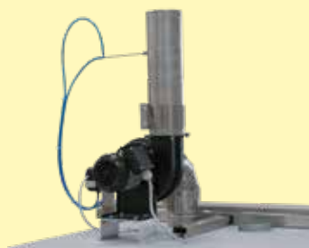
Zuluftöffnung und leistungsstarkes Abluftgebläse auf dem Ofen montiert
